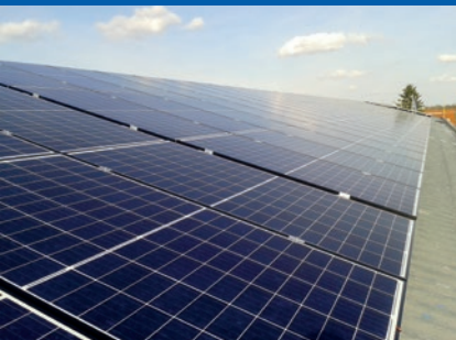
Mieterstrom-Projekt in Kirchheim bei München, fertiggestellt im Oktober 2017
